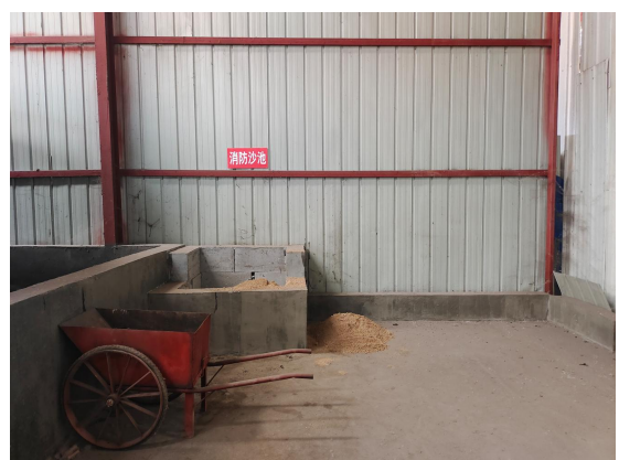
项目车间内消防沙池
