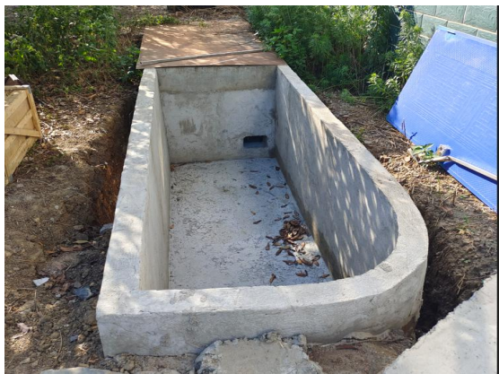
项目车间外事故池
